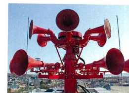
11 <屋外> モータサイレン
