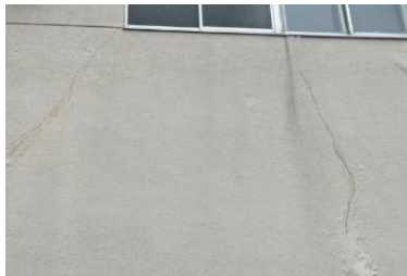
外壁材の割れ・剥離
