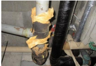
配管設備の劣化
