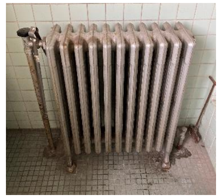
旧式の暖房設備
