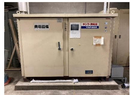
旧式の非常用発電設備
