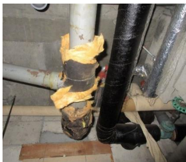
設備配管の劣化
