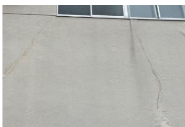
外壁材の割れ・剥離
