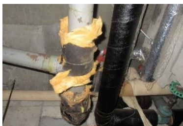
配管設備の劣化
