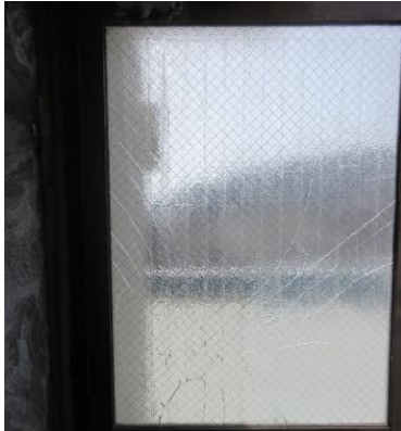
割れている窓
