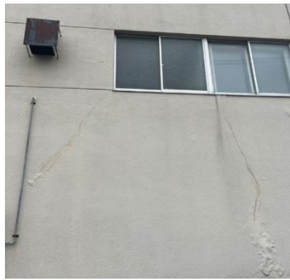
外壁材の割れ・剥離
